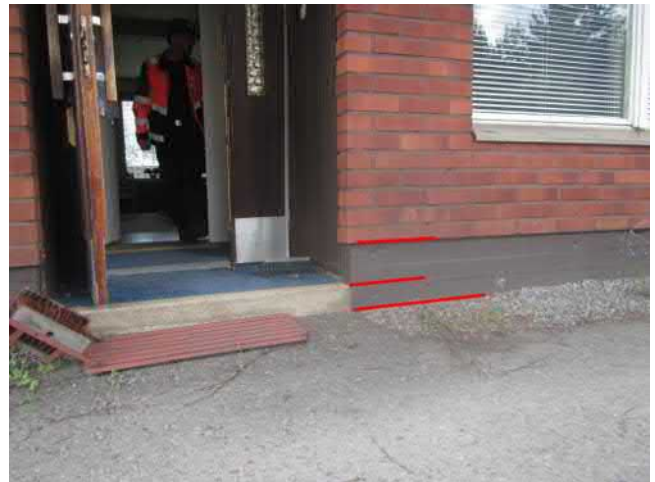
Kuva 8 Sokkelin ulkopinta nousee lattiapinna yläpuolelle ja alaojhauspuu sijaitsee betonilaatan yläpinnan tasolla.
