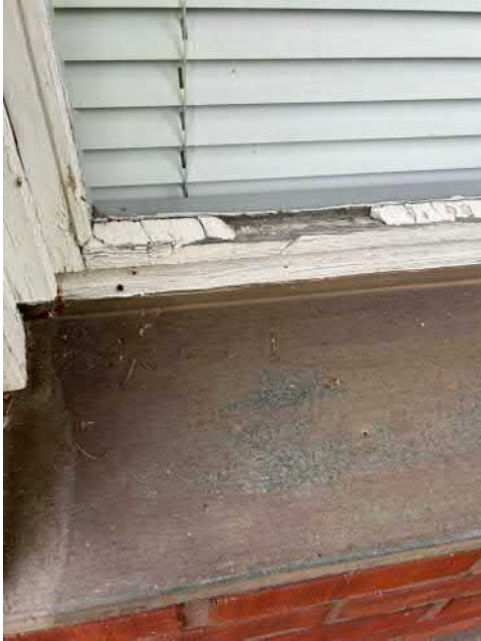
Kuva 11 Ikkunat ovat huonokuntoisia puuikkunoita.
