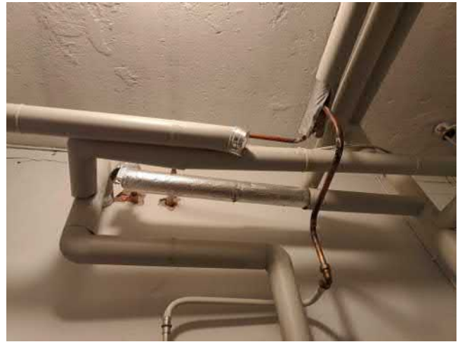
Kuva 32 Eristeiden pinnoitteet osin irti ja villapintoja näkyvissä.
