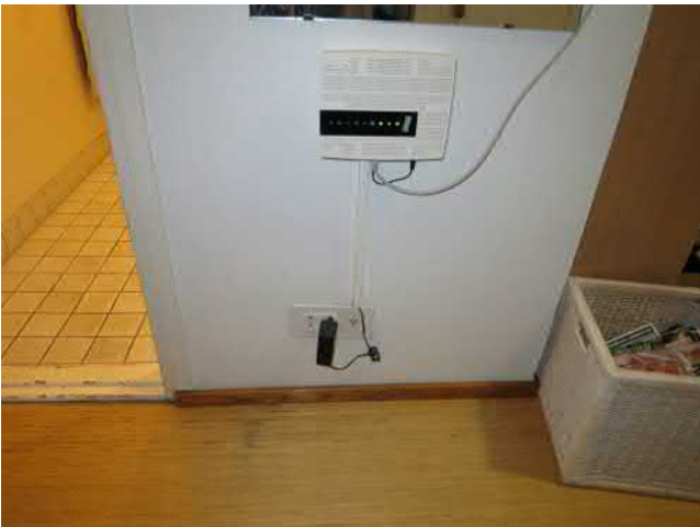
Kuva 51 Puhelinverkkoon liitetty internet yhteyden laite.
