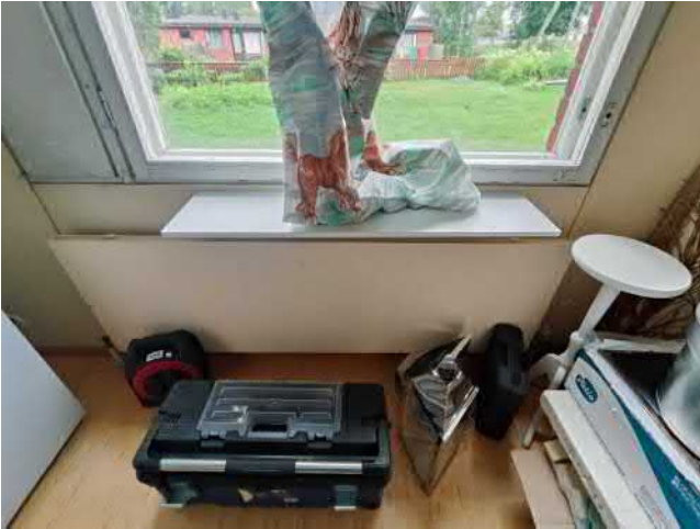
Kuva 30 Yleiskuva lämmityspattereista ja patteriventtiileistä. Patterirungot lattian sisällä.
