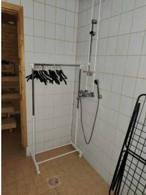
Kuva 33 Yleiskuva vesi- ja viemärikalusteet.
