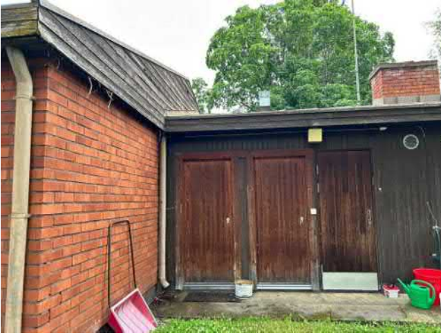
Kuva 9 Julkisivun puuverhous on huonokuntoinen.
