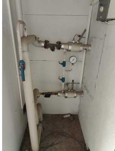
Kuva 27 Yleiskuva kaukolämmön mittaus.
