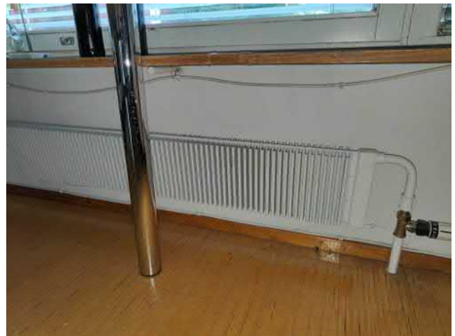
Kuva 29 Yleiskuva lämmityspattereista ja patteriventtiileistä. Patterirungot lattian sisällä.
