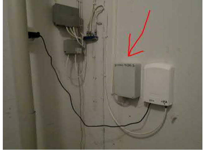
Kuva 50 Teknisessä tilassa on valokuitupääte. Näytti olevan liitettyä antenniverkkoon muuntimella.
