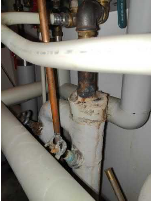
Kuva 26 Venttiileissä havaittavissa korroosiota/syöpymää. Eristeissä mahdollisesti asbestia.
