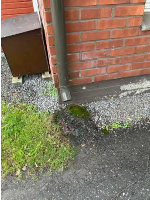
Kuva 3 Sokkelin maalipinta on hilseillut paikoitellen.
