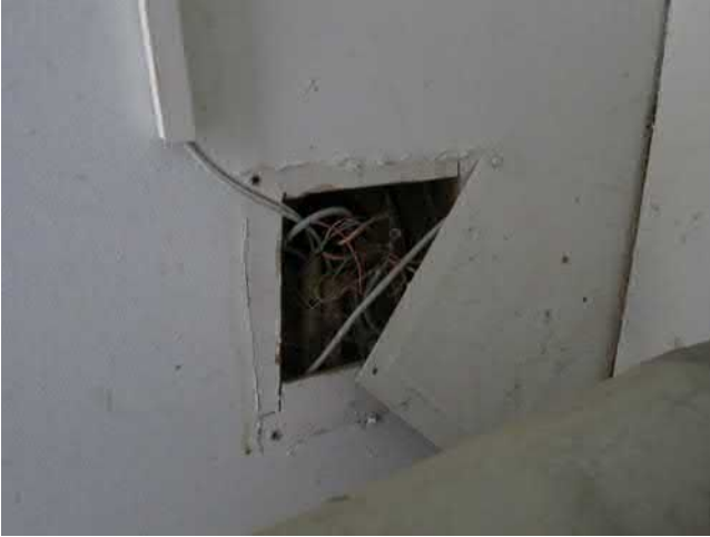
Kuva 49 Puhelinkytäkotelon teknisessä tilassa. Kansilevy auki.
