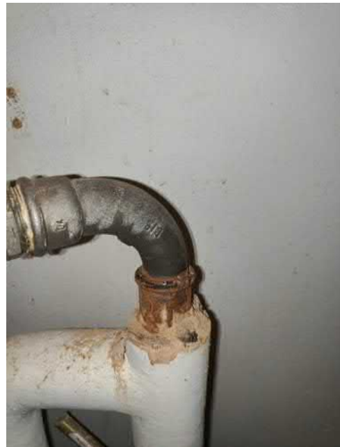
Kuva 25 Putkistoissa pintaruostetta. Eristeissä mahdollisesti asbestia.
