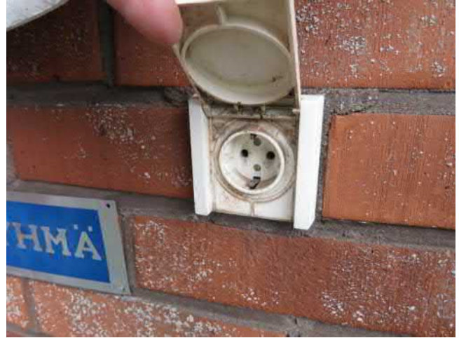
Kuva 44 Ulkoseinän pistorasia, sulkulaite puuttuu (lapsisuoja)
