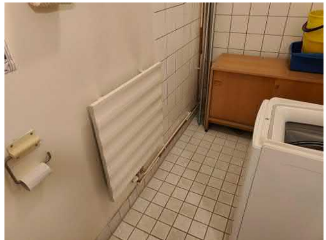
Kuva 36 Kiertovesipatteri. Putkia uusittu ilmeisesti vuotojen takia.
