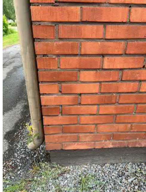
Kuva 10 Tiiliverhouksen saumat ovat paikoitellen rapautuneet. Tiilissä on yksittäisiä halkeamia.
