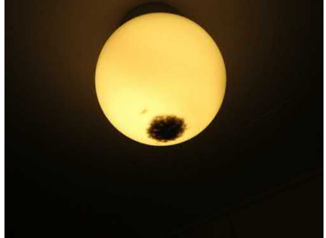
Kuva 46 Asunnon kylyhuoneen kattovalaisin. Kellastunut ja likainen Alkuperäinen vuodelta 1971
