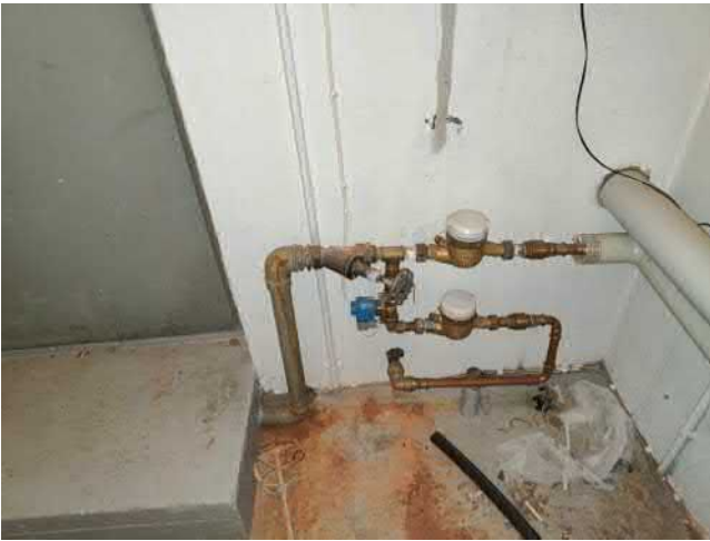
Kuva 31 Päävesimittarit ja tonttijohto.
