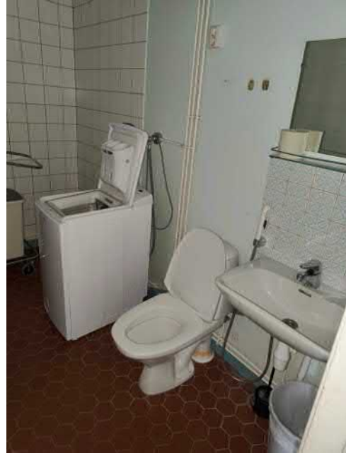
Kuva 34 Yleiskuva vesi- ja viemärikalusteet.
