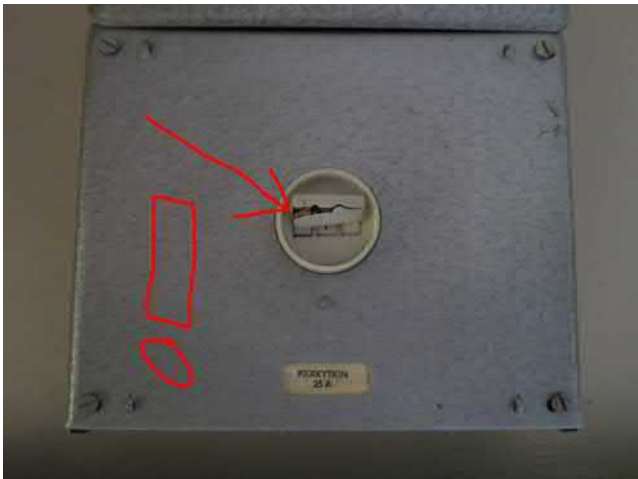
Kuva 42 Asunnon ryhmäkeskuksen pääkytkin murentunut.
