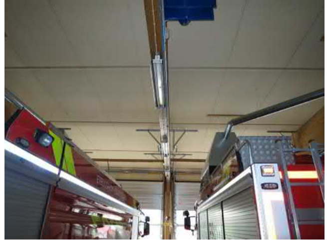
Kuva 85 Hallin valaisin. Loisteputkivalaisin.
