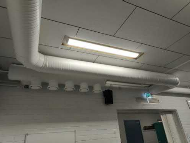
Kuva 74 Yleiskuva kanavat ja päätelaitteet.
