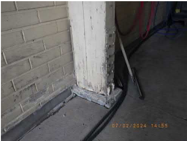
Kuva 25 Pesuhallin tiiliseinän alaosassa on paikoin kosteuden aiheuttamaa maalipinnan hilseilyä.
