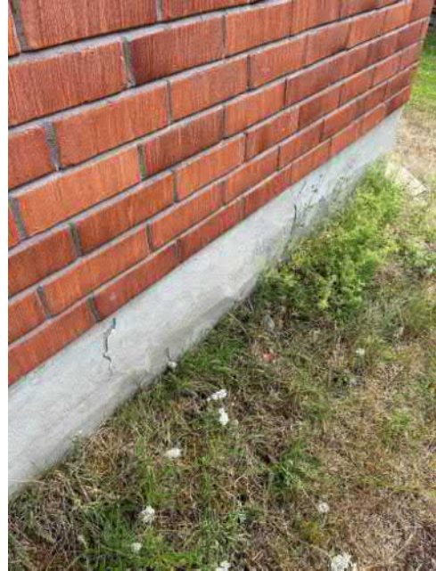
Kuva 6 Sokkeleiden pinta irtoilee
