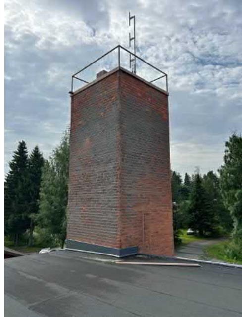
Kuva 20 Letkutornin seinässä kasvaa jäkälää.
