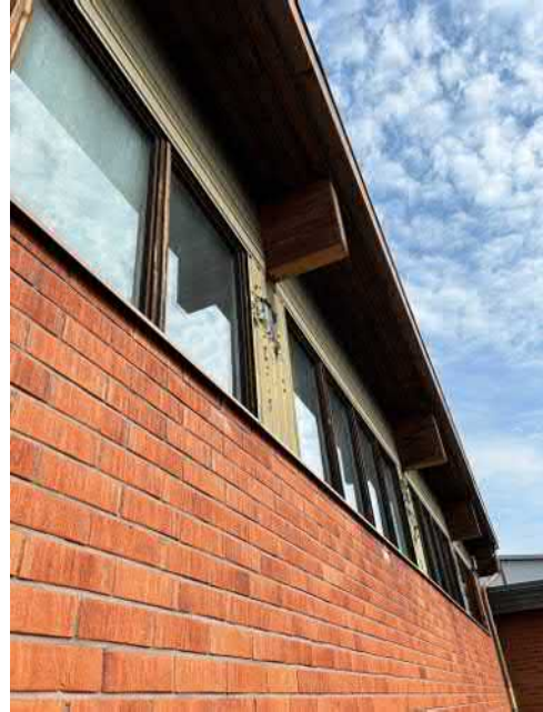
Kuva 24 Peltijulkisivun maalipinta on huonokuntoinen.
