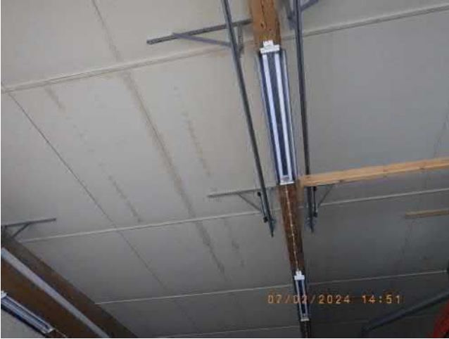
Kuva 35 Sisäkattopinnoissa on paikoin vesivuotojälkiä.
