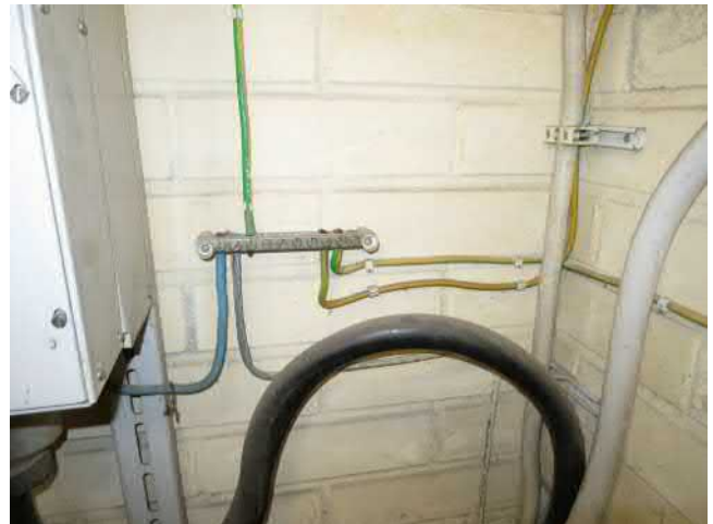
Kuva 80 Pääpotentialitasauskisko ja siihen liitettyt maadoitusjohtimet, SPK-tila. Merkinnät puuttuvat.
