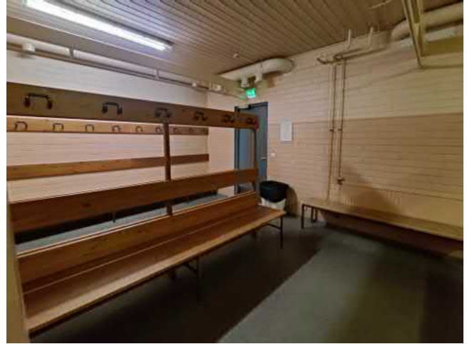
Kuva 71 Yleiskuva kanavat ja päätelaitteet.
