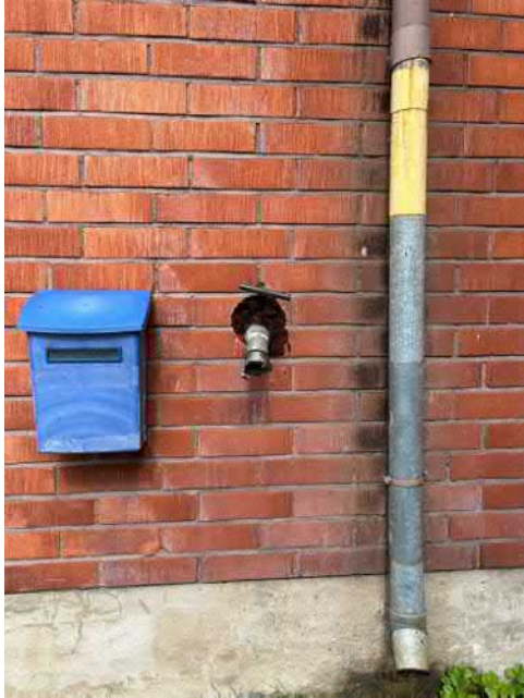
Kuva 23 Julkisivussa on tiivistämättömiä läpivientejä.
