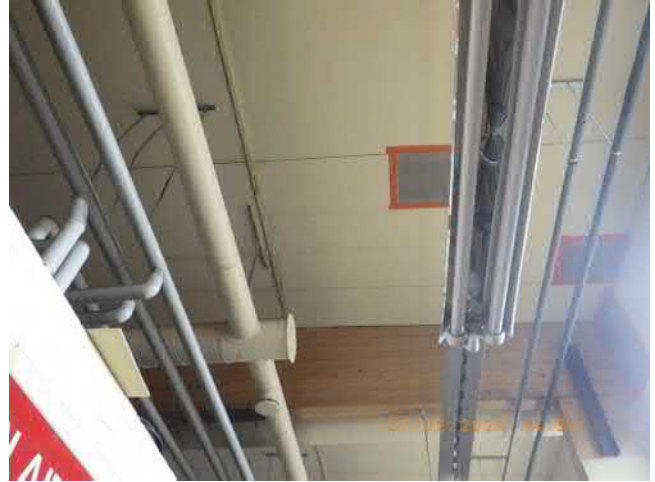
Kuva 36 Yläpohjan rakenneavauskohta on paikkakorjaamatta.
