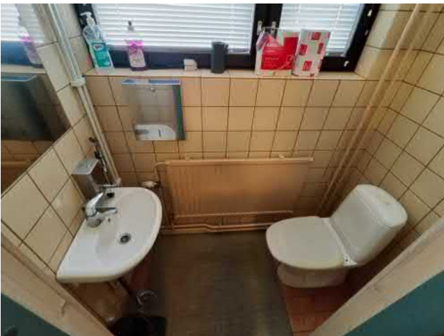
Kuva 51 Yleiskuva laajennusosan lämmityspatterit, kytkentäputket ja termostaativenttiilit (2000?).
