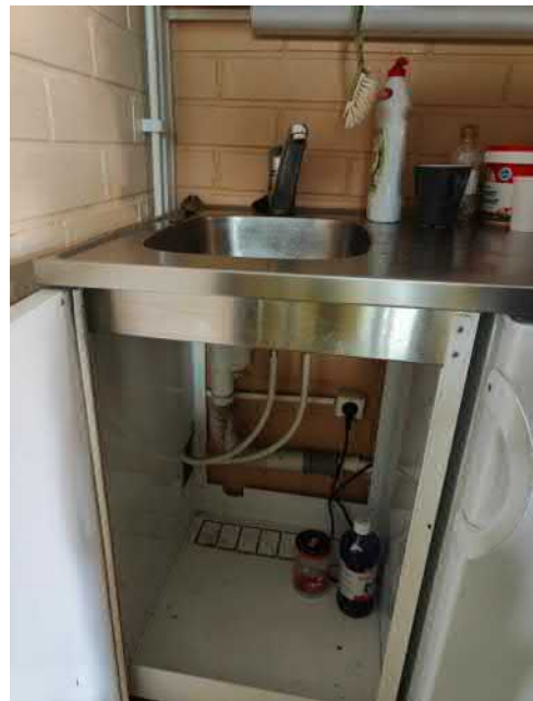
Kuva 58 Laajennusosalla osa käyttövesiputkista uusittu komposiitilla. Keittöaltaan viemäri supistuu virtaussuunnassa DN32. Tällä osalla myös muita ongelmia viemärien vetämisen kanssa. Allaskaapeissa ei havaittu aktiivisia vuotojälkiä.
