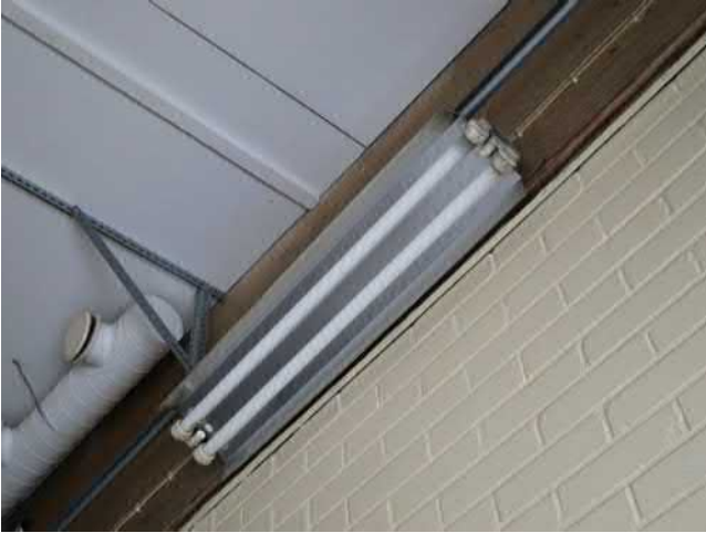
Kuva 84 Pesuhallin valaisin, loisteputkivalaisin. Tilassa pestään vesiletkuin ja on kosteutta tilassa. Valaisin näyttää olevan kuivaan tilaan tarkoitettu valaisin. Valaisimessa ei riittävästi kotelointia. Valaisimet kuitenkin korkealla.
