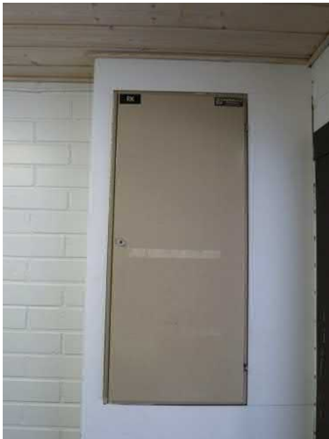
Kuva 79 Huoltorakennusosassa (liikuntatilat), vanhahko ryhmäkeskus sisäänkäynnin komerossa. Vanhempaa aikakautta kuin muut huoltorakennusosan sähköistyksset.
