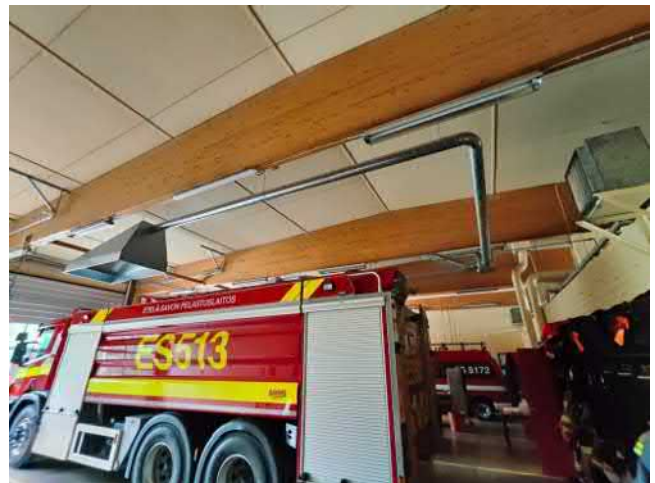
Kuva 65 Autojen yläpuolella olevat kohdepoistot uusittu/lisätty hiljattain. Ajankohta ei ole tiedossamme.
