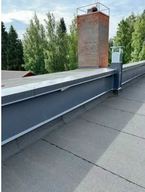
Kuva 31 Paloaseman katon harjatuuletushuuvan rakennuslevy roikkuu ja on irtonainen kiinnityksistään.
