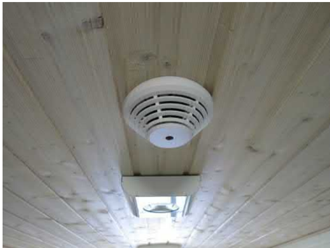
Kuva 98 Palovaroitin, käytävä. Liikuntatilojen käytävä.
