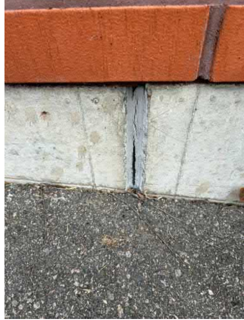
Kuva 10 Huoltorakennuksen elementtisokkelirakenteisen sokkelin elementtisaumat ovat huonot. Vesi pääsee rakenteisiin.
