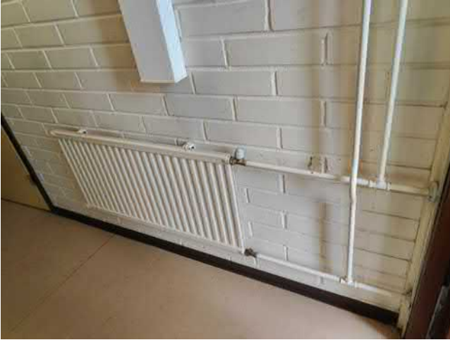
Kuva 49 Yleiskuva laajennusosan lämmityspatterit, kytkentäputket ja termostaativenttiilit (2000?).
