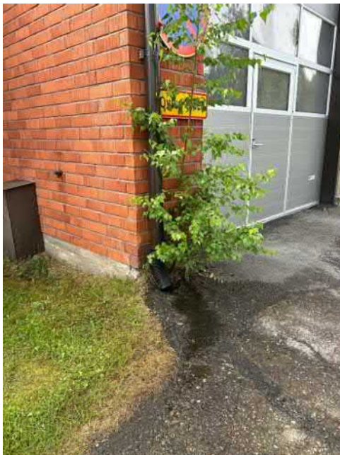
Kuva 3 Kattovedet ohjautuvat asfaltille paloasemarakennuksen nurkalla, joka voi olla pakkaskelillä liukas.
