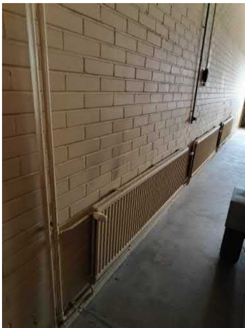
Kuva 47 Hallin lämmityspatterit havaintojen perusteella alkuperäiskuntoiset. Termostaatti- ja patteriventtiilit uusittu jossain vaiheessa, ajankohta ei ole tiedossamme.
