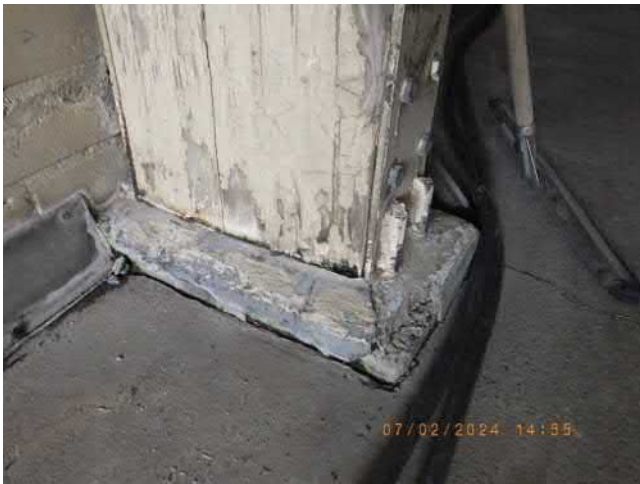
Kuva 16 Pilarin alapäässä on kosteusvario
