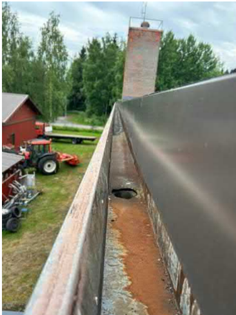
Kuva 29 Paloaseman sadevesikouruissa on ruostetta.
