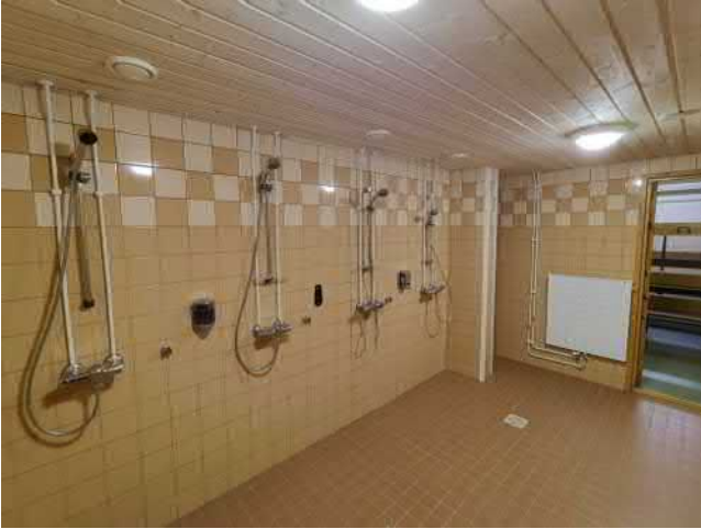
Kuva 70 Yleiskuva kanavat ja päätelaitteet.
