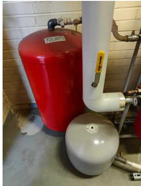
Kuva 44 Yleiskuva paisunta-astiat. Osa ilmeisesti uusittu 2015, osa vanhempia. Edellinen huolto- ja paineiden tarkastuksen ajankohta 2.1.2015.
