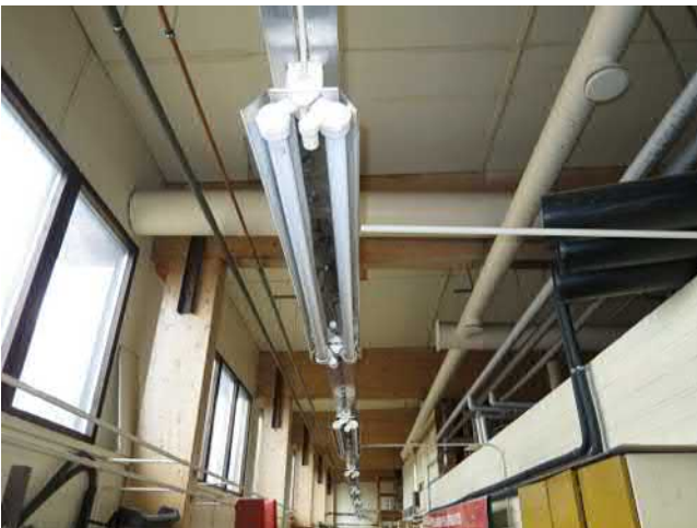
Kuva 86 Hallin taustatilojen valaisin, loisteputkivalaisin.
