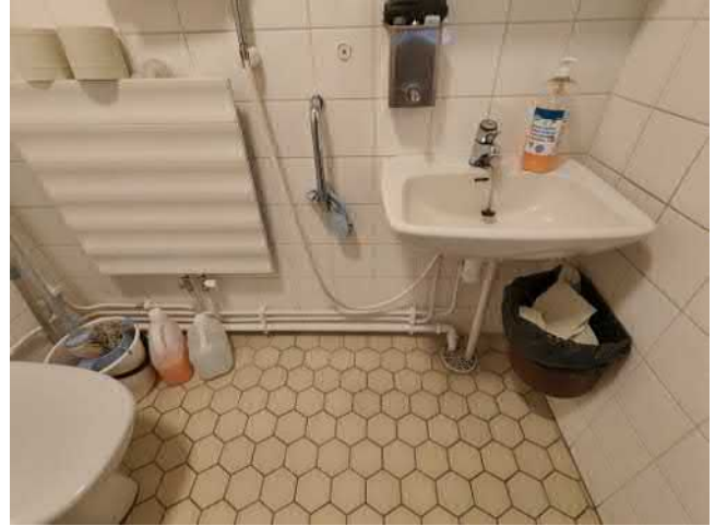
Kuva 60 Käyttövesiputket uusittu komposiitilla. WC-istuin ja allashana vanhempia.
