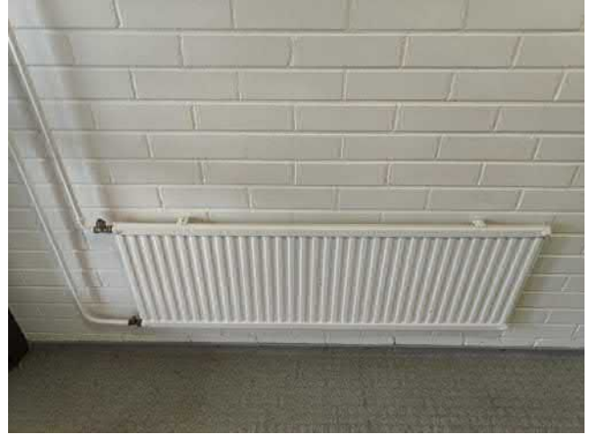
Kuva 50 Yleiskuva laajennusosan lämmityspatterit, kytkentäputket ja termostaativenttiilit (2000?).
