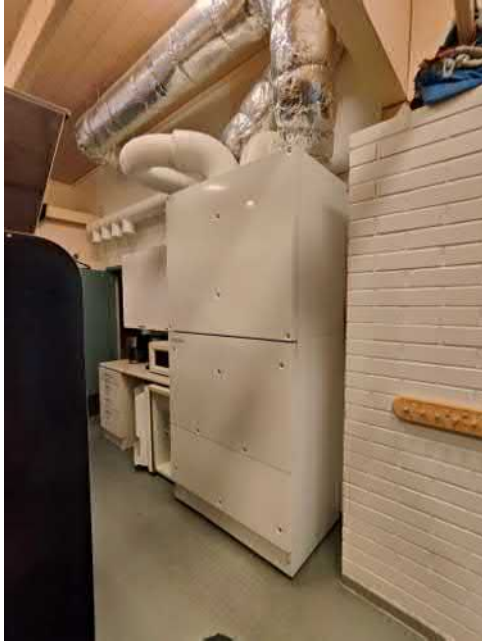
Kuva 66 TK01 Pukuhuoneiden iv-kone.
