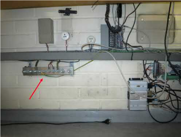
Kuva 81 Potentiaalintasauskisko, vanhan osan toimistopöydän alla. Maadoitusjohtimien merkinnät puuttuvat.
