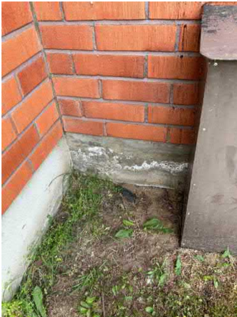
Kuva 7 Sokkeleiden pinnassa on kosteudesta/lämpövuodosta aiheutunutta kalkkeutumaa ja värjäytymää.
