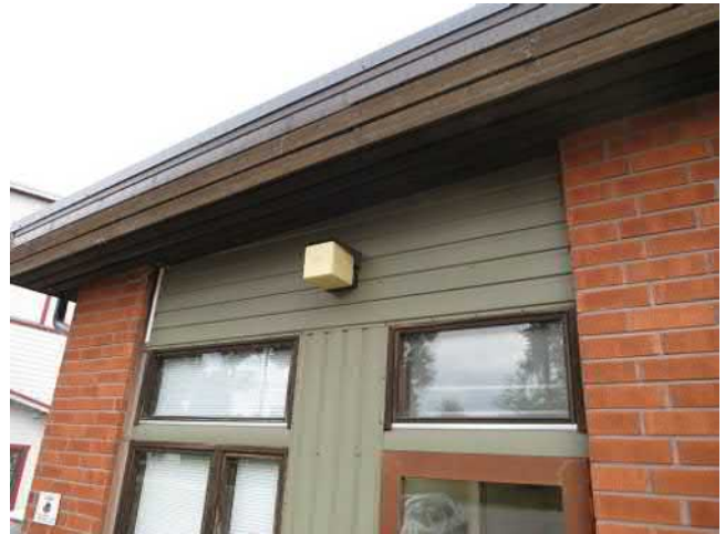
Kuva 83 Ulkoseinällä valaisimen kupu kellastusnut. Elohopeahöyrylamppu.
