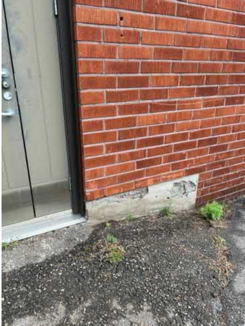
Kuva 5 Sokkeleiden pinta irtoilee
