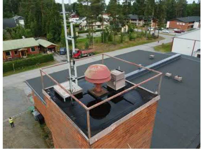
Kuva 32 Letkutornin katolla on vettä, kallistukset eivät ohjaa vettä ulkoisen heittäjän kautta pois katolta.
