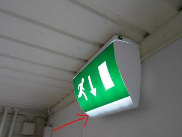
Kuva 93 Poistumistievalaisin. Kärpäsiä tai muuta likaa kuvun sisällä Huoltorakennusosaa (liikuntatilat).
