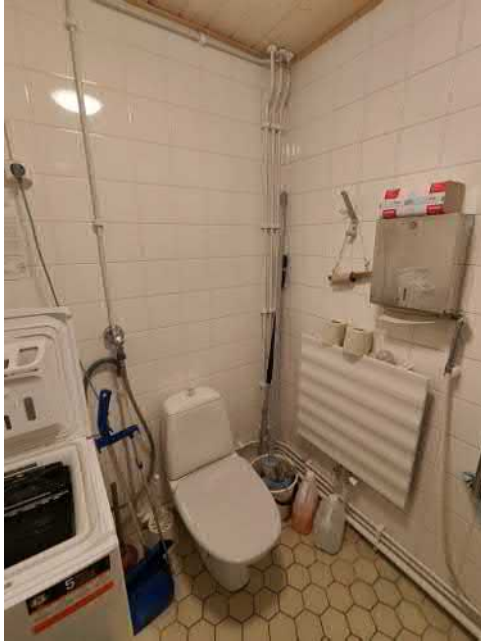
Kuva 59 Käyttövesiputket uusittu komposiitilla. WC-istuin ja allashana vanhempia.
