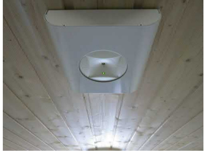
Kuva 94 Turvavalaisin, led-valaisin. Huoltorakennusosaa (liikuntatilat).
