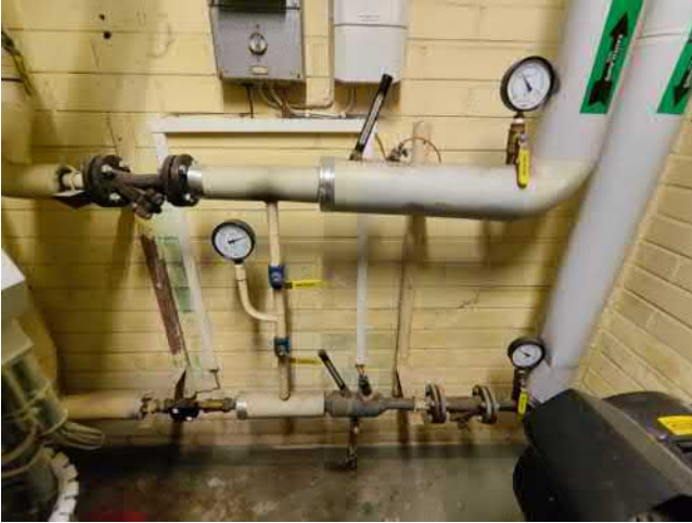
Kuva 45 Kaukolämpöputkisto alkuperäinen. Etäluettava mittaus.
