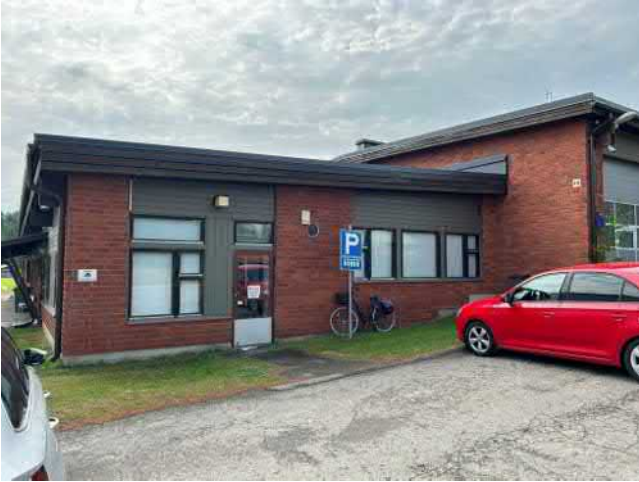
Kuva 1 Huoltorakennuksen päädyn sisäänkäynnin kohdalla nurmialue viettää rakennukseen päin, seinässä on kosteudesta aiheutunutta värjäytymää ja pintavaurioita.
