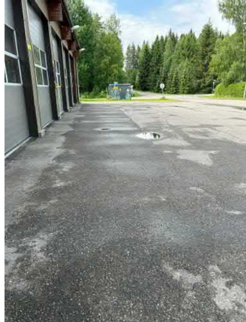
Kuva 2 Palokaluston ovien edessä asfalttialue on tasainen ja siinä on vähäisiä painaumuksia, joissa seisoo vesi.
