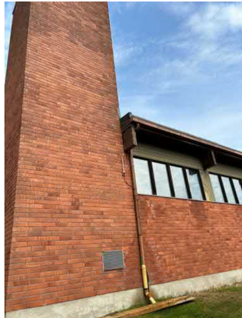
Kuva 30 Syöksytorvet vuotaa seinille vettä.
