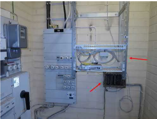
Kuva 96 ATK-jakamo ja puhelinristikytöntääteline. Pääkeskushuone.
