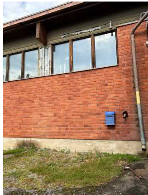
Kuva 22 Paloaseman syöksytorvien kohdalla on julkisivuverhouksessa kosteudesta aiheutunutta värjäytymää.
