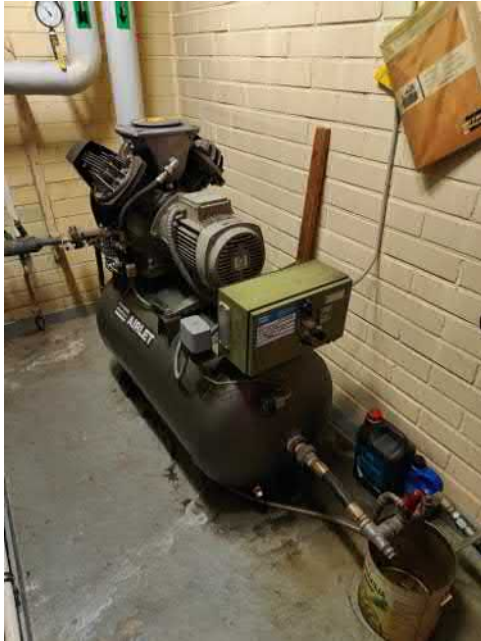
Kuva 75 Paineilmakompressori Atlas Copco LE7. Edellinen huolto 23.8.2023.
