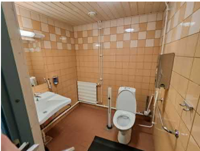
Kuva 61 Yleiskuva 2015 uusituista vesi- ja viemärikalusteista laajennusosalla.
