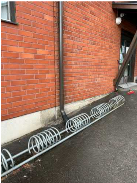
Kuva 21 Huoltorakennuksen uuden ja vanhemman puolen syöksytorven kohdalla on julkisivuverhouksessa kosteudesta aiheutunutta värjäytymää.
