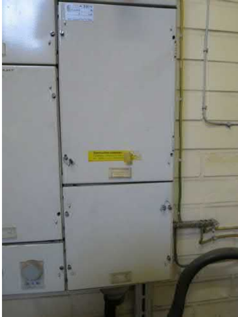
Kuva 77 Sähköpääskus. Alkuperäinen vuodelta 1981
