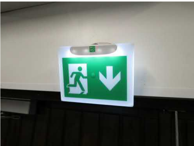
Kuva 95 Poistumistievalaisin, led-valaisin. Huoltorakennusosaa (liikuntatilat).
