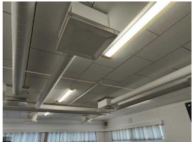
Kuva 73 Yleiskuva kanavat ja päätelaitteet.
