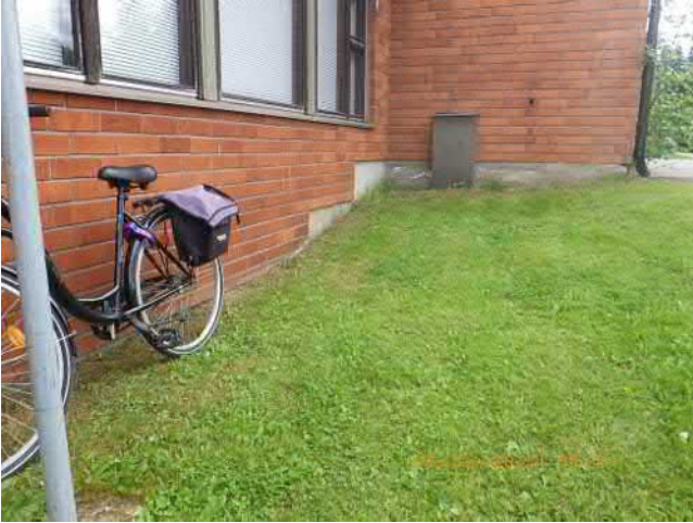
Kuva 19 Ulkoseinien alaosat ovat paikoin maanpinnan tasolla.
