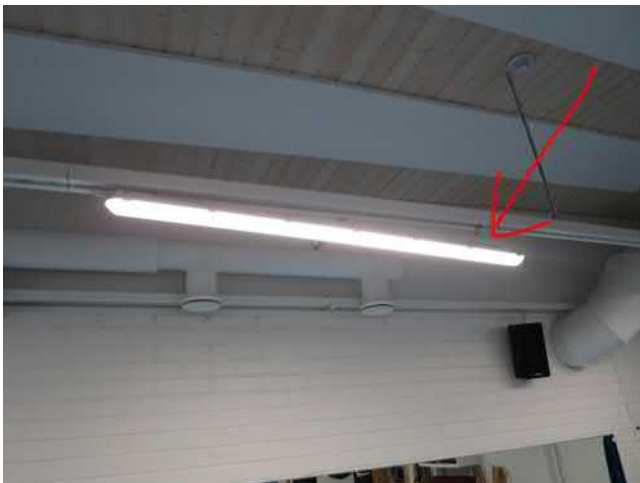
Kuva 90 Jumppasali. Valaisin kiinnitys irronnut, valaisin roikkuu toisesta päästä. Valaisimet uudehkoja.
