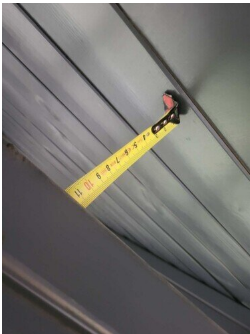
Kuva 11 Yläpalkeissa juuttumisvaara, mikäli välineessä kiipeillään.
