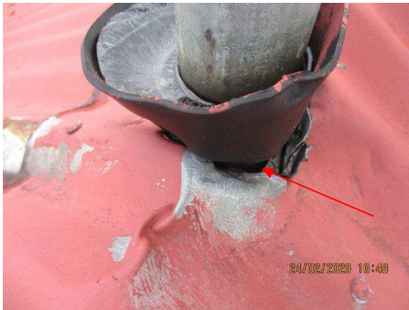
Kuva 33. Antennin läpivienti epätiivis.
