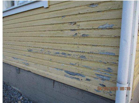
Kuva 22. Takapihan puolelta julkisivun maalipinta hilseilee.
