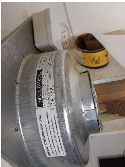
Kuva 62. Poistoilmapuhallin teknisen työn luokassa.
