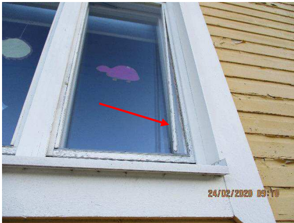
Kuva 26. Ensimmäisen kerroksen ikkunapuitteen lista irti ulkopuolelta. Maalipinnassa hilseilyä. Ikkunapeltien kiinnityksissä ei havaittu puutteita.
