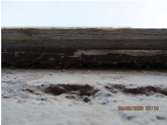
Kuva 23. Julkisivupaneloinnin takan ei ole kunnollista tuuletusrakoa.
