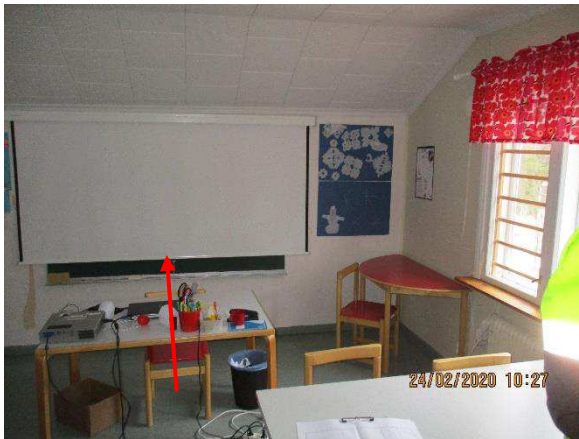
Kuva 46. Opetustilakäytössä oleva makuuhuone, 2. krs. Seinän takana on ullakkotila, jonne ei ole tehty kulkuaukkoa/tarkastusluukkuja.
