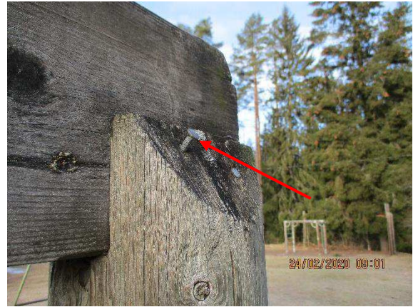
Kuva 7. Kiipeilytelineen kiinnitysnaula työntynyt ulos. Puuosissa sammalkasvustoa.
