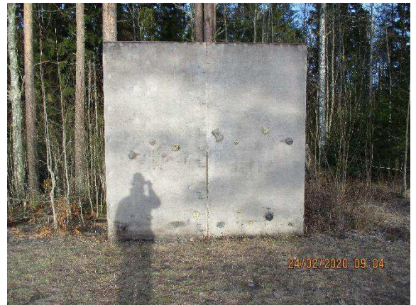
Kuva 9. Kiipeilyseinä, jonka pinnoitteet ovat pahoin kuluneet. Takapuolella tukipuu on päässyt irti kiinnityksestään.
