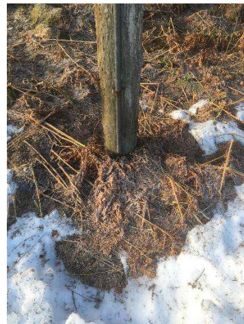
Kuva 66. Puutteellinen kaapelin suojaus valaisinpylvään juuressa.
