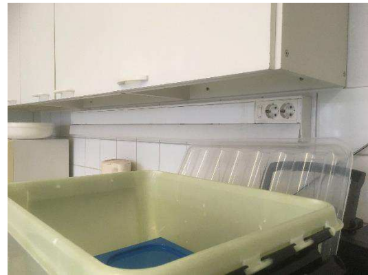
Kuva 76. Keittiön rikkinäinen työpistevalo.
