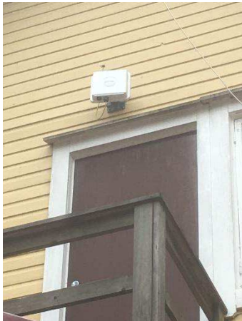
Kuva 84. Kiinteistön langattoman verkon laitteita.
