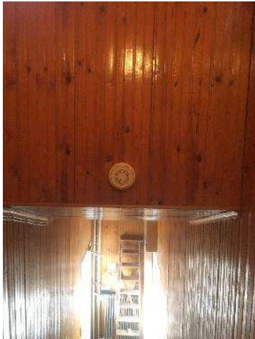
Kuva 64. Palovaroitin asennettu väärin.
