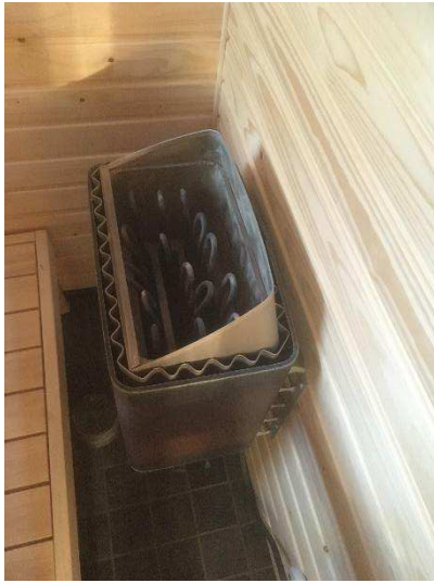
Kuva 81. Saunan kiuas, joka ei ole käytössä.
