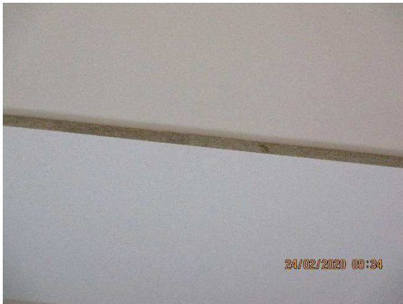
Kuva 42. Akustolevyjen reunat ovat pinnoittamattomia.
